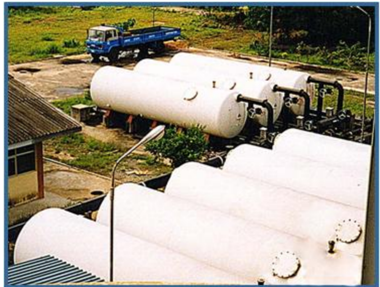
▲ NR - Horizontal Filters Isashi, Lagos, Nigeria
